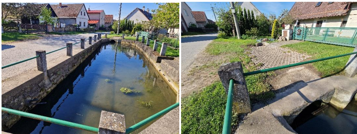
Obr. č. 14: Fotodokumentace kritického bodu KB01
