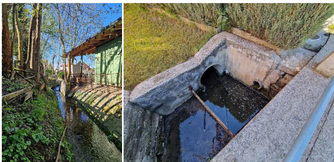
Obr. č. 13: Fotodokumentace kritického bodu KB01
